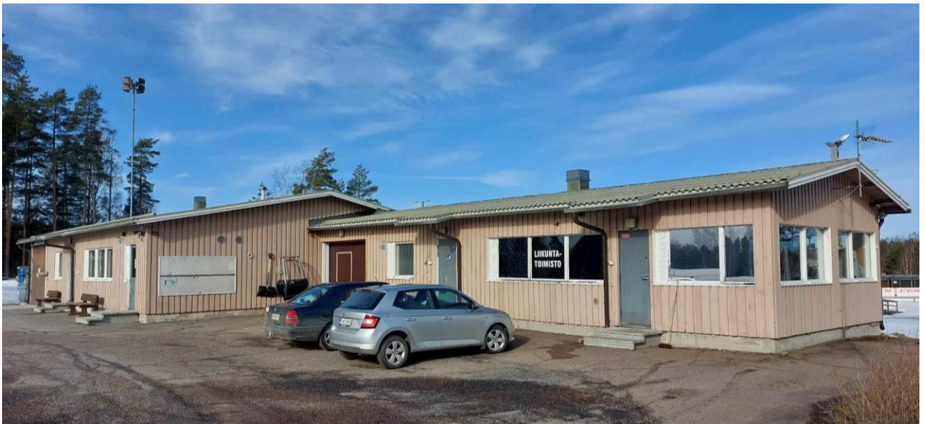
Kuva 67. Huoltorakennus, Mäntyharjun urheilualue. Kuvan rakennuksen kunto heikko.
